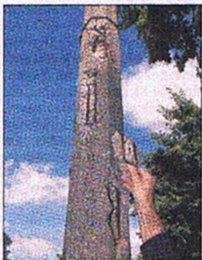
An dieser Straßenlampe in der Hoernlestraße platzen Betonbrocken ab. Foto: Ralf Drescher
